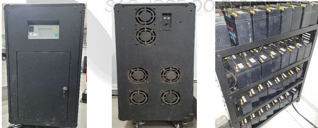
Imagem 2: Nobreaks 10KVA TRUNNY 100 AI e Baterias (para os 3 equipamentos são necessárias 48 baterias estacionárias seladas VRLA de (12V/18Ah) e 21 ventiladores Bivolt 12x12x38 com rolamentos.)
