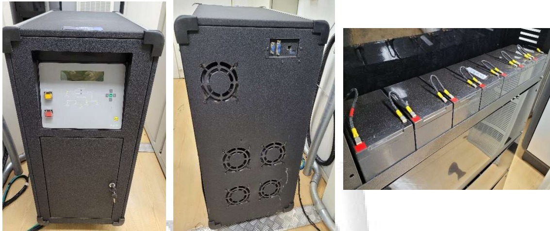
Imagem 1: Nobreak Schneider Eletric 15KVA Modelo Classic 150 e Baterias as VRLA 12V/12AH
